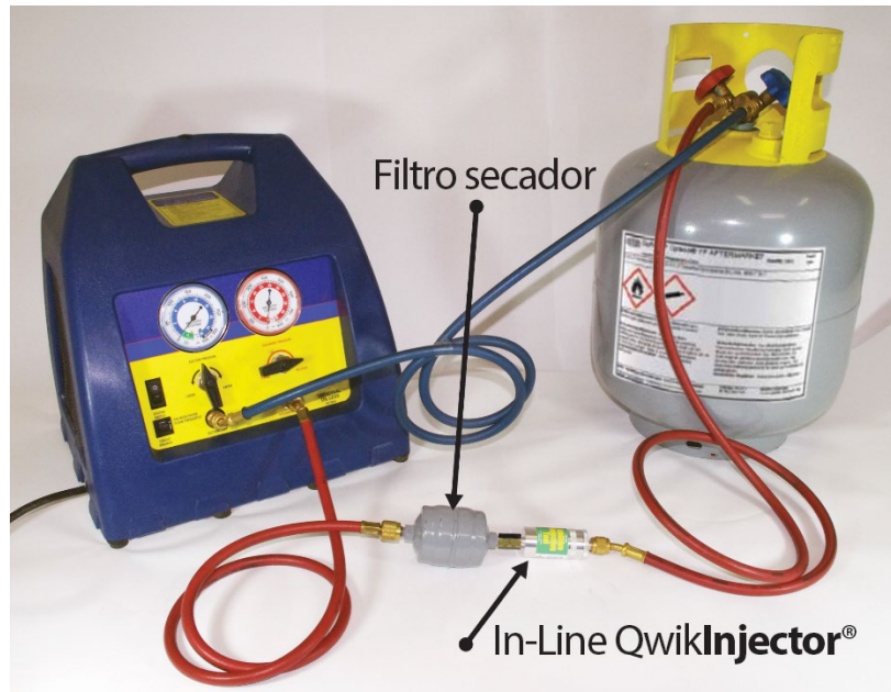
Figura 7. Fotografía del refrigerante que se limpia y filtra
