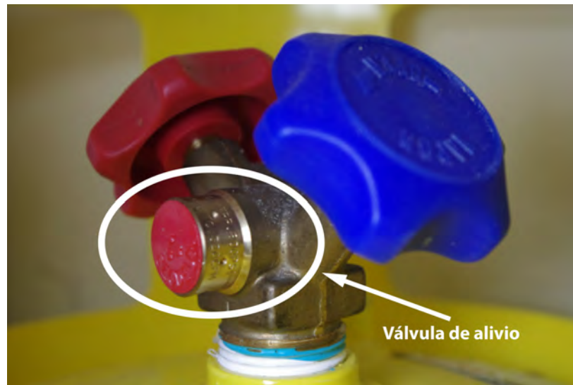
Figura C-9. Válvula de alivio de presión en un tanque de recuperación
